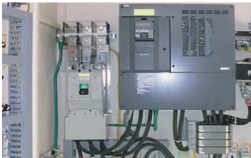
高圧配電盤 スイッチの 明示物
