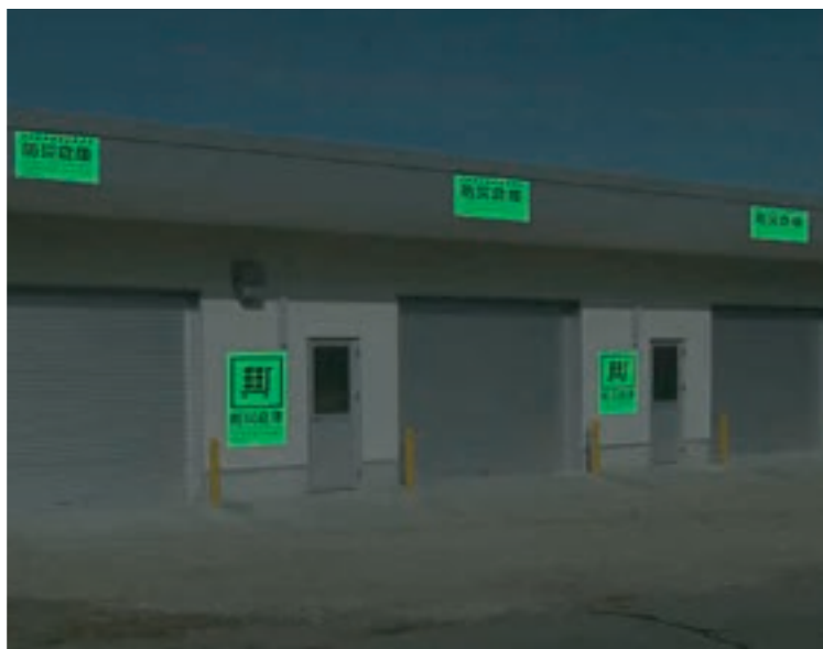
■防災倉庫銘板
