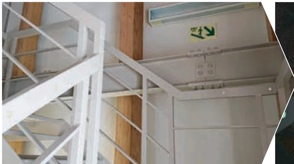
階段手摺の 明示物と 避難誘導標識
