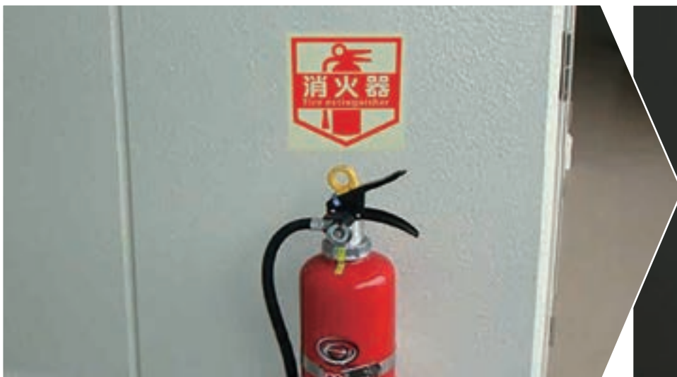
消火器の 設置場所標識
