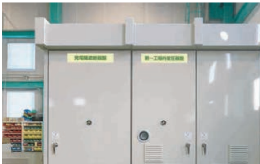
高圧配電盤 扉の明示物
